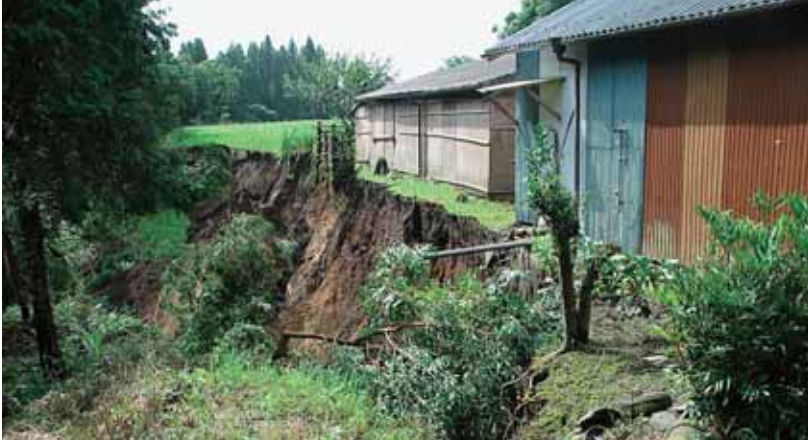
大隅町中尾地区の災害現場
