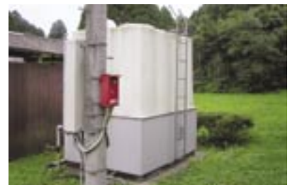
白毛集落の水道加圧ポンプ施設
