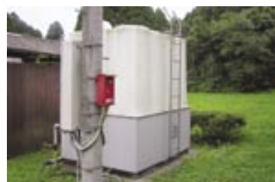
白毛集落の水道加圧ポンプ施設
