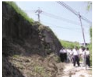
大隅菅牟田の災害現場
