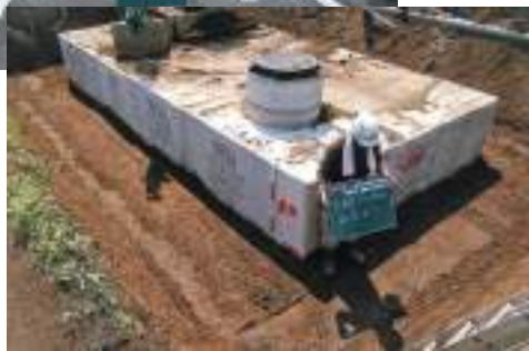
市道に埋設された防火水槽
