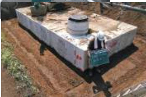
市道に埋設された防火水槽
