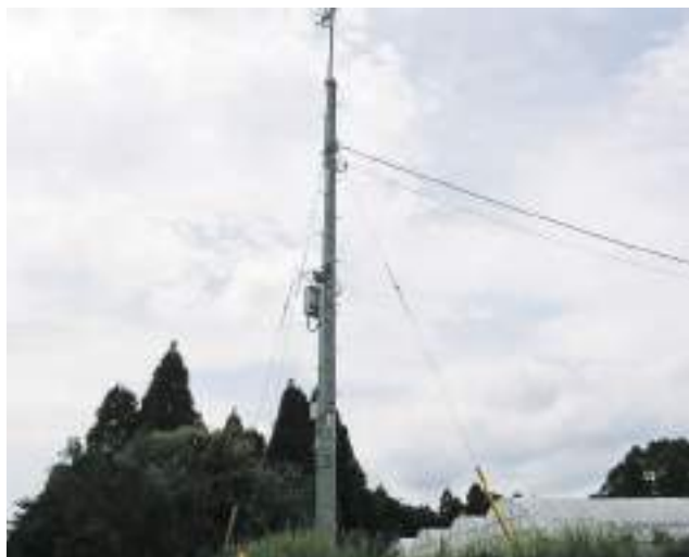
小山共同受信施設（大隅町大隅南地区）
