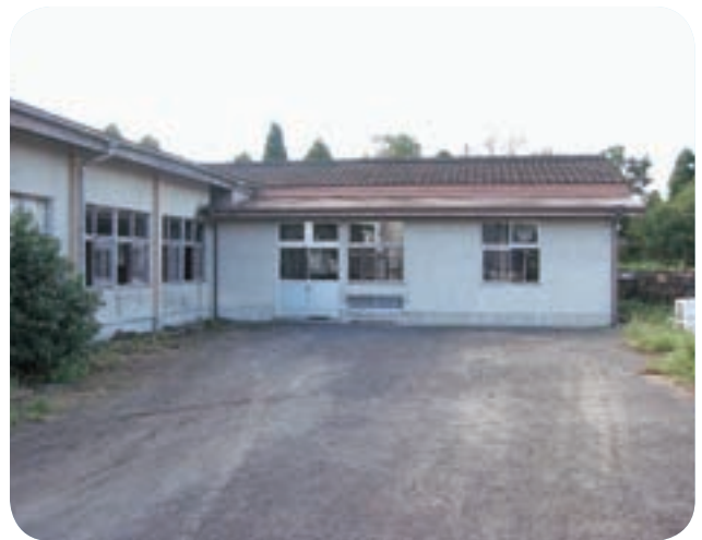
老朽化が進んでいる大隅婦人の家
