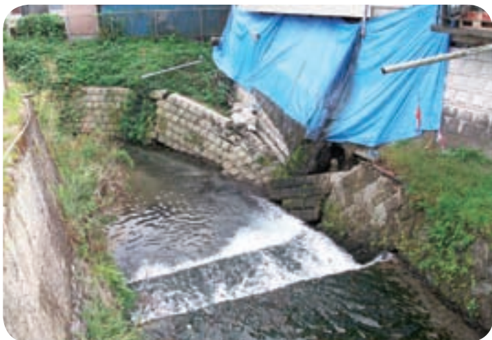
大川原駅前の被災地
