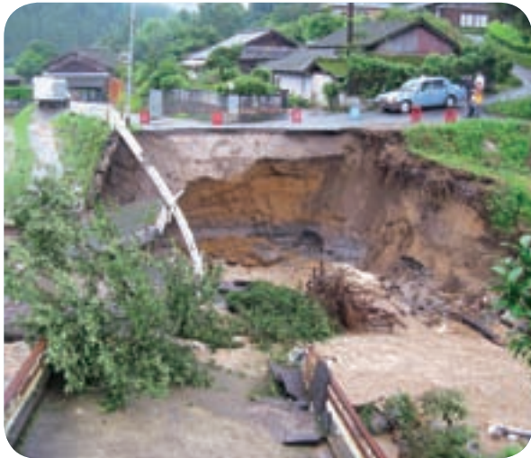
流失した踊橋
