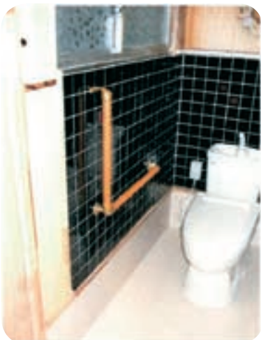
トイレに取り付けられた手すり
