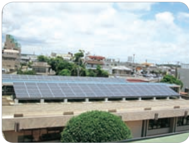
環境にやさしい太陽光パネル (曾於市役所)
