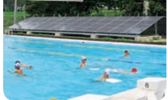
設置されたクリーンエネルギーの太陽光発電 (財部中)
