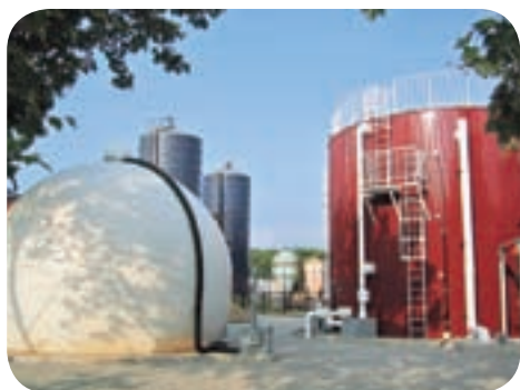
バイオマスシステム (若手県葛巻町役場より提供)
