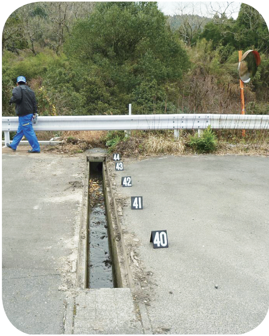
グレーチングの盗難現場
