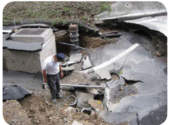
被害状況（石之脇地区）
