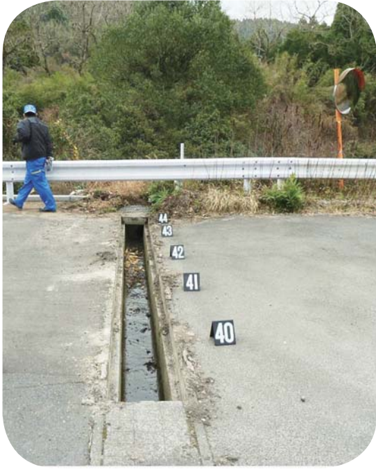
グレーチングの盗難現場
