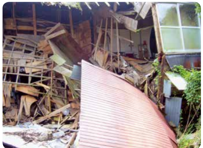
放置された危険家屋
