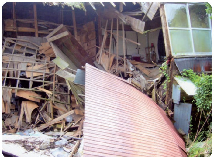
放置された危険家屋
