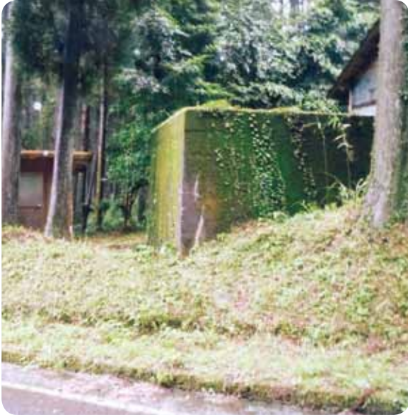
集落水道の水源地
