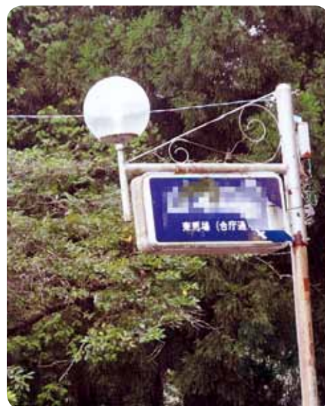
修繕が必要な街路灯
