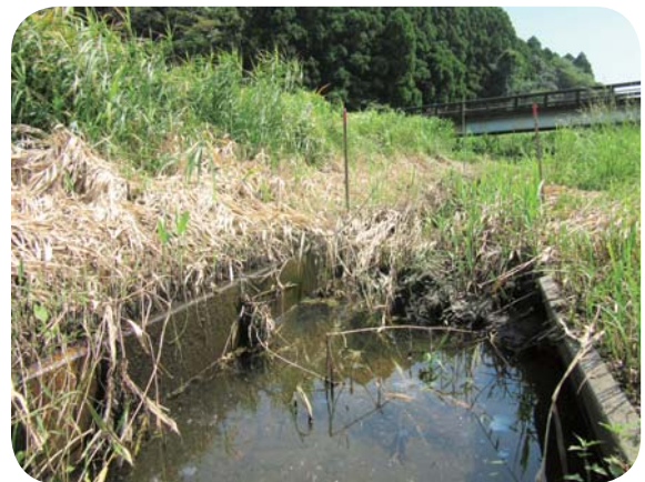
草が繁茂する水路
