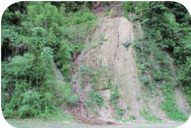
がけ崩れ危険個所には危険表示を
