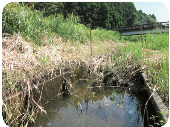
草が繁茂する水路
