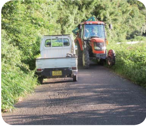
早急な整備が必要な道路
