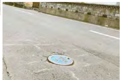
荒れた路面（十文字地区）
