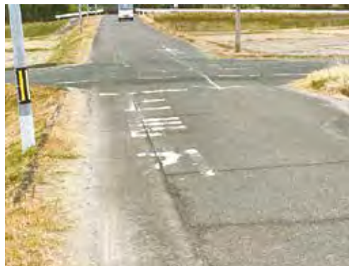
消えている路面標示
