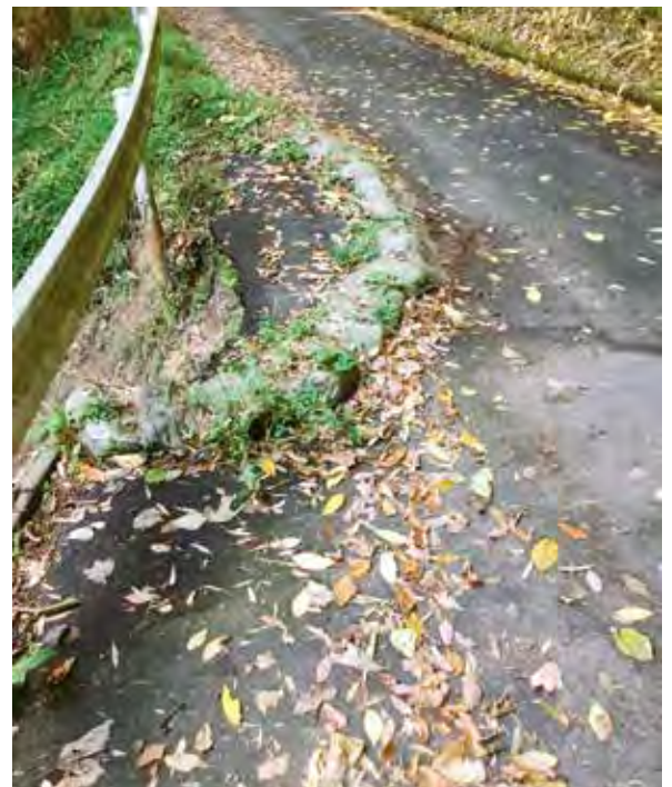
復旧が待たれる災害現場
