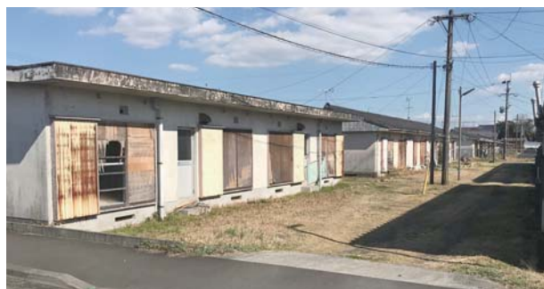
老朽化した市営住宅
