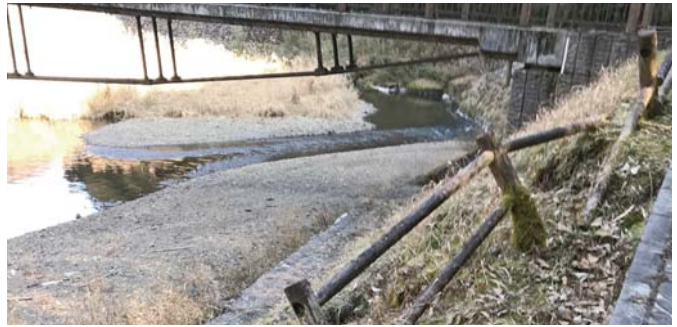
早期改修が望まれる防護柵
