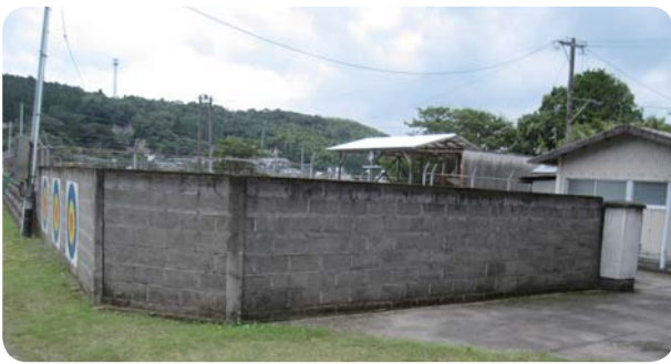
学校敷地内のブロック塀
