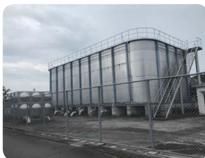
桜ヶ丘排水池
