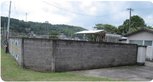
学校敷地内のブロック塀
