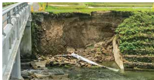
中津橋付近被災状況
