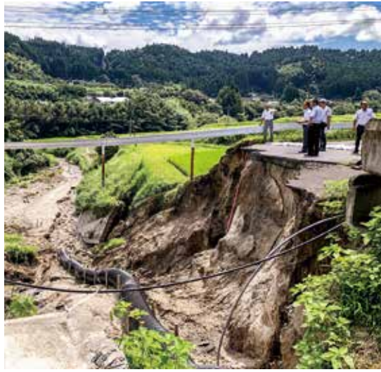
崩落現場確認
