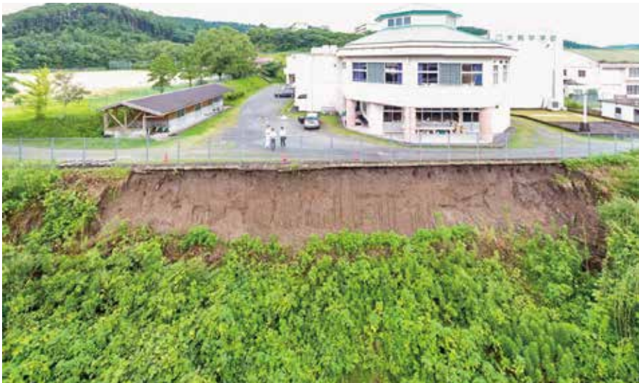
大隅中学校敷地法面崩落災害状況
