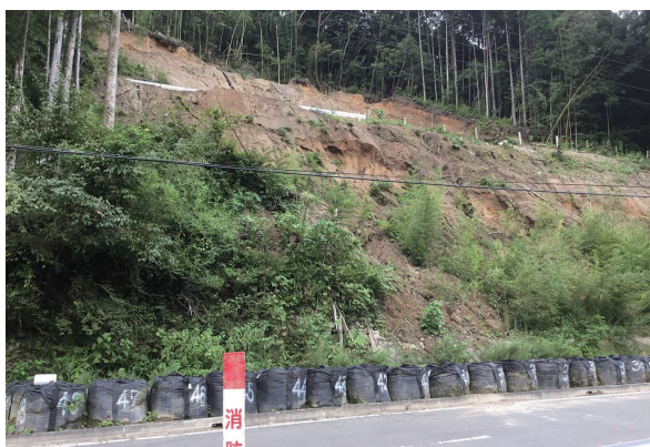
市道河原・飛佐線の災害現場
