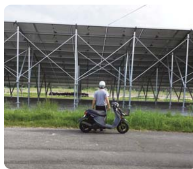
太陽光発電設置箇所
