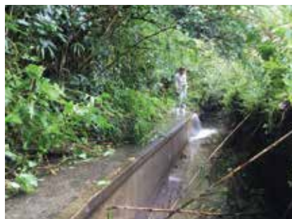
用を成していない排水路
