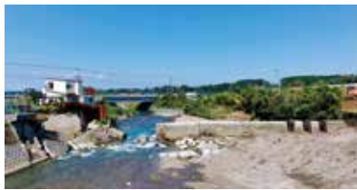
昨年の梅雨前線豪雨で被災した大内田地区頭首工
