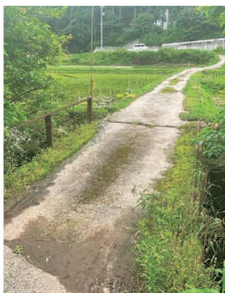
架替が急がれる財部町荷込地区の橋
