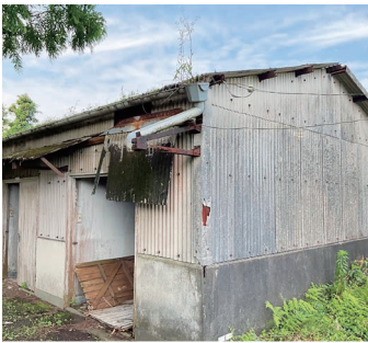
老朽化が進んでいる倉庫
