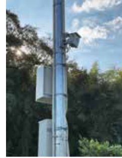
月野川に設置の監視カメラ（大隅町月野・持留橋）
