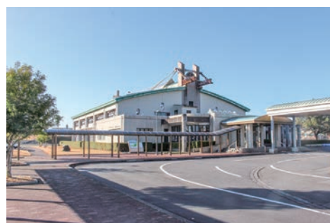
改修が必要な市民プール
