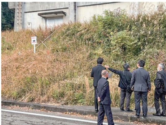
直径約1m、深さ約3m程の陥没を確認しました
