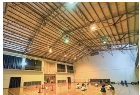
電球が切れたままの財部地区体育館
