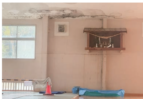
大隅運動公園武道館雨漏りの状況
