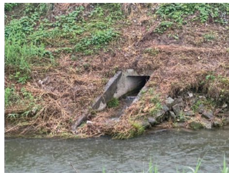
前川に接続する老朽化した排水口
