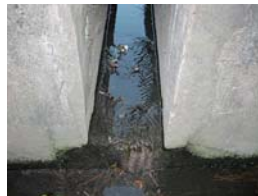
単独処理浄化槽 (白く濁った水が流れています)
