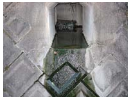
合併処理浄化槽 (透明な水が流れています)
