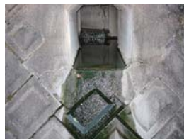
合併処理浄化槽 (透明な水が流れています)
