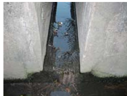
単独処理浄化槽 (白く濁った水が流れています)
