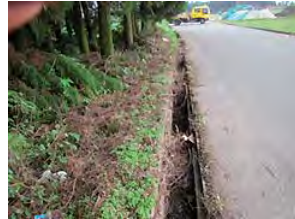
側溝の土砂堆積
