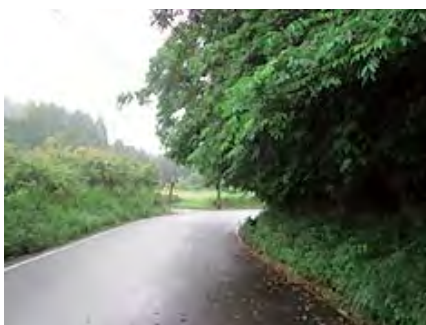
道路に張り出している樹木
