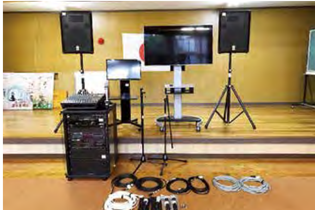
正ヶ峯地区公民館に整備された音響設備
