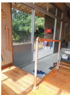
改修補助を受け設置された手すり
