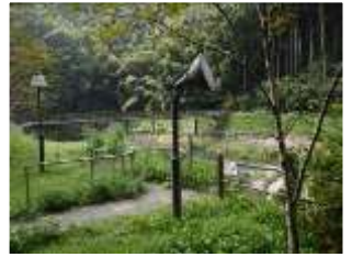
既存照明設備
