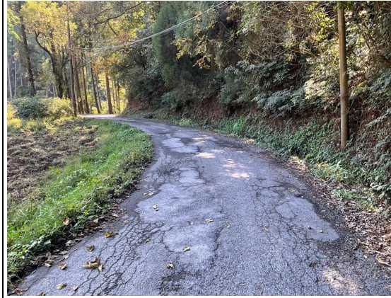
舗装補修予定箇所
