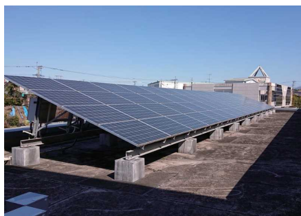
本庁舎に設置されている太陽光発電施設
