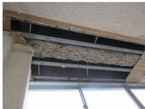
梁施工不良（教室棟2号棟2階廊下）
