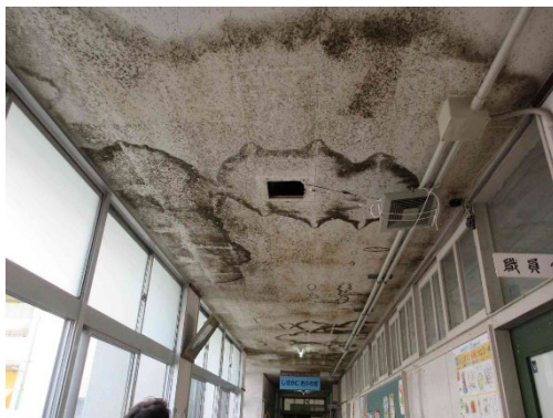
廊下天井の雨漏れ（教室棟1号棟1階）
