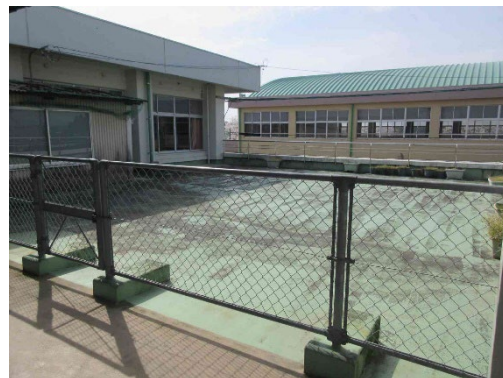
屋根防水の剥がれ（教室棟1号棟屋上）
