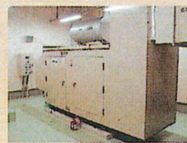
自家発電機室
