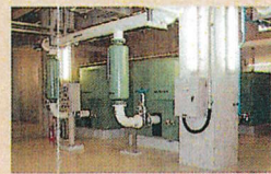
水処理機械室
